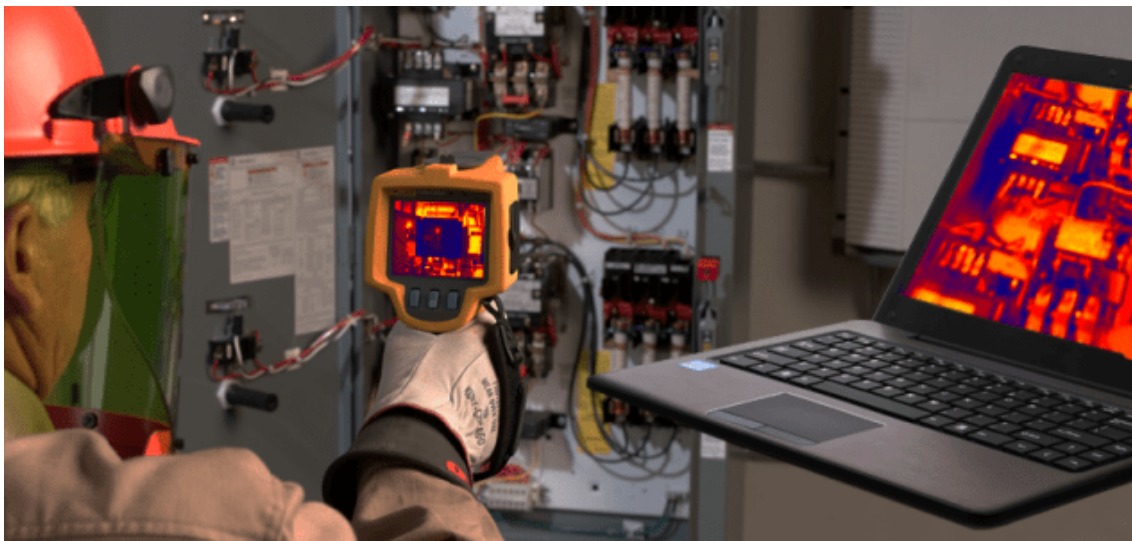
Рисунок 20. Пример проведения тепловизионного контроля электрошкафа
