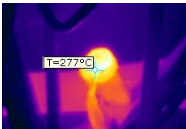
Рисунок 22. Пример обнаружения пожароопасного разогрева болтового контактного соединения
